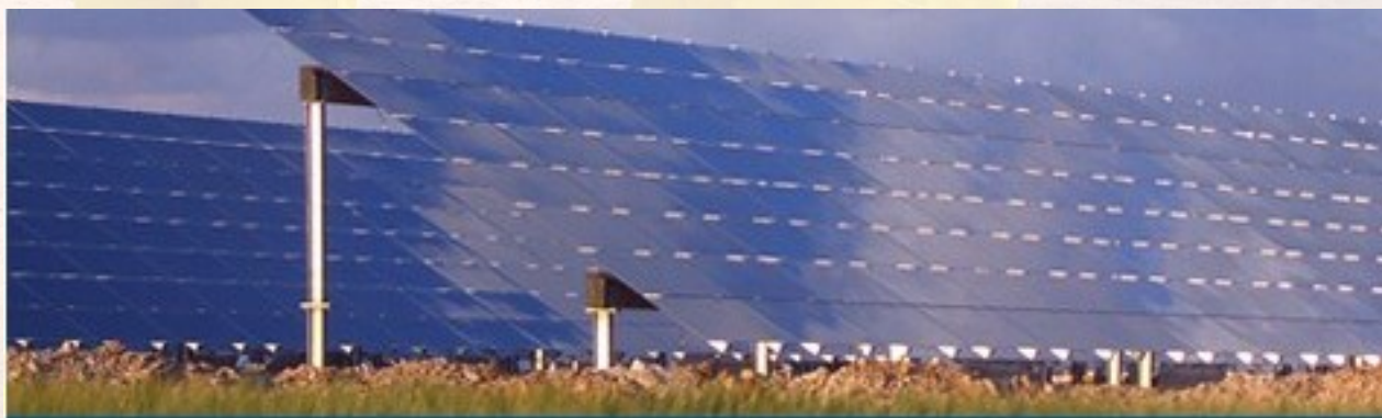
Exemple d'un Parc Photovoltaïque
